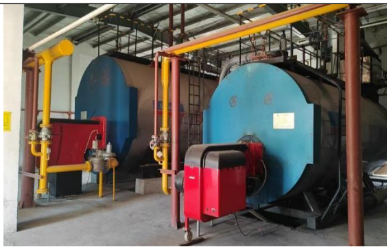
2台锅炉及配套低氮燃烧器
